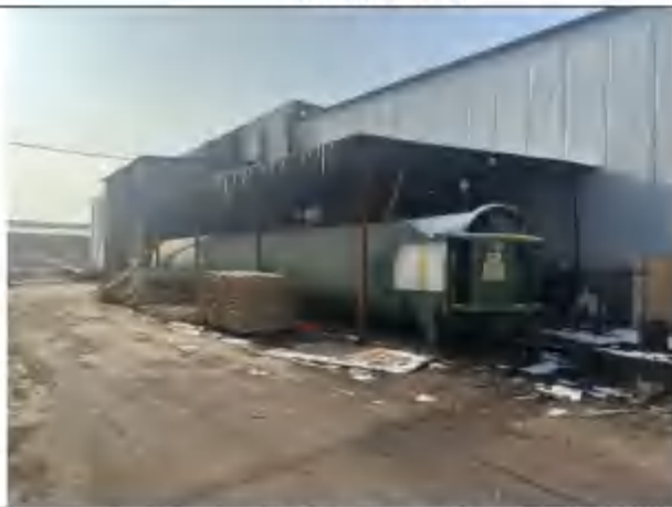
厂外阻燃剂加注装置
