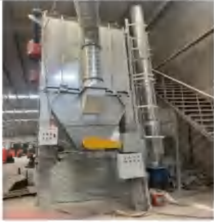
厂房内布袋除尘器
