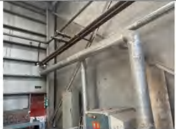
厂房内活性炭处理装置
