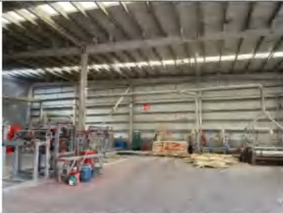
厂房内集气管道
