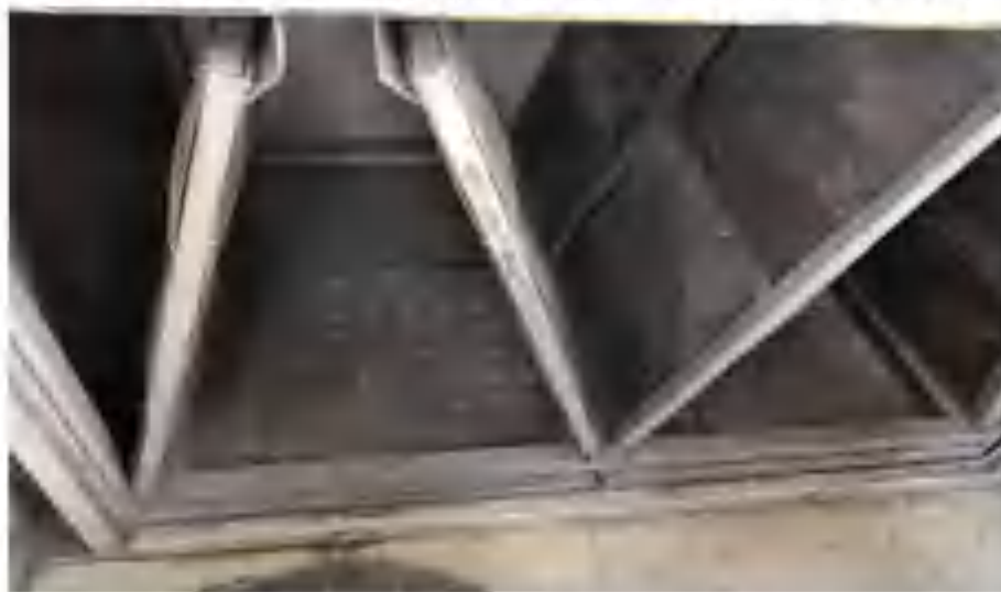
图 6.2-1 吸附箱内部活性炭吸附板
