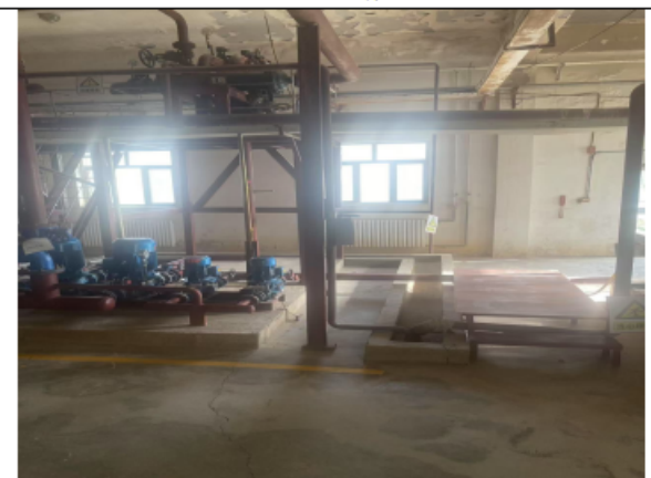
分汽缸室管道
